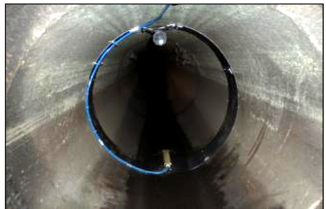
Unten: In Zuleitung (DN700) eingebauter Durchflusssensor
