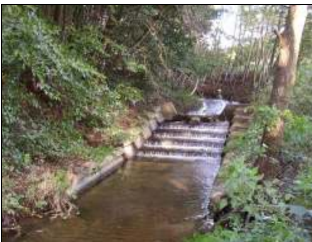
Kücknitzer Mühlenbach – Sohlabsturz. Für viele Gewässerorganismen sind steile Sohlabstürze unüberwindbare Hindernisse. Oberhalb von Abstürzen kann es daher zur Verarmung der Gewässerbiozönose kommen.
